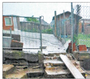
Immer wenn es stärker regnet, schauen die Labrenzs aus Beckendorf nicht nur in den Himmel, sondern auch in den Garten. Das Wasser sucht sich seinen Weg und läuft von hier in den Hof. Foto: L. Labrenz
